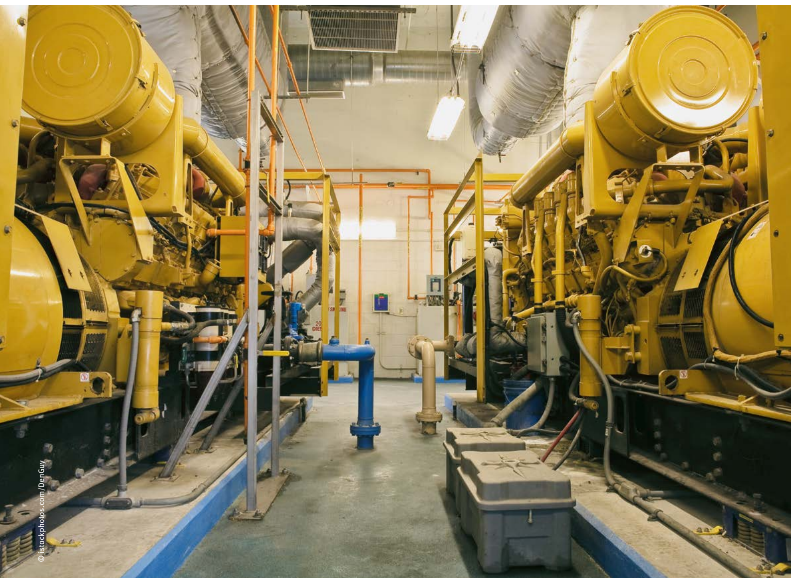
Stationäre Notstromaggregate helfen, die Stromversorgung im Winter zu sichern
